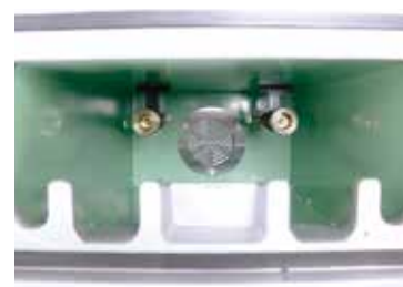
Compartimento de aire comprimido y agua.
