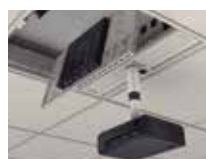
CAJA DE TECHO
